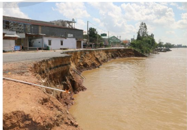
Hình 1.4. Sạt lở đất ở quốc lộ 91 đoạn đi qua xã Bình Mỹ, huyện Châu Phú, tỉnh An Giang năm 2019
